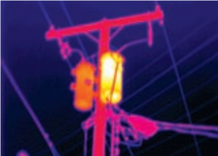
Figure 5-84. Cette image thermique indique que le transformateur se trouvant sur la droite présente une panne interne.
