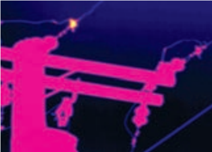
Figure 5-16. Une connexion présentant une forte résistance au niveau d'un câble de liaison (phénomène probablement dû à la corrosion) peut avoir de graves conséquences en cas de montée en puissance de la charge.
