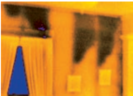
Figure 5-69. Un isolant en vrac mal installé dans une cavité murale existante peut se tasser et ne pas avoir l'effet attendu.
