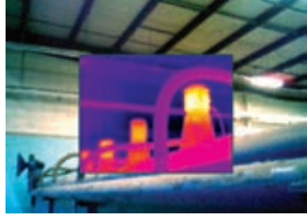
Figure 5-6. Le moteur du ventilateur de recirculation présent sur le côté droit du four à recuit, bien plus chaud que les autres, semblerait défaillant.
