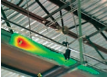
Figure 5-67. La signature thermique montre une zone d'échauffement causée par le frottement d'une courroie contre le plateau du convoyeur aérien. La présence d'un roulement de roulement usé à proximité a affecté l'alignement de la courroie, dont la friction ainsi intensifiée a contribué à la surchauffe du moteur d'entraînement.
