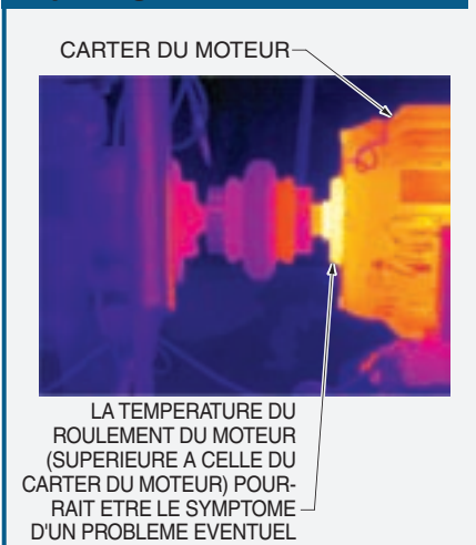
Figure 2-2. Un roulement de moteur qui serait beaucoup plus chaud que le carter du moteur laisserait entendre un éventuel problème de graissage ou d'alignement.
