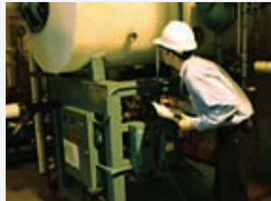
Figure 10-1. Les techniciens de maintenance procèdent régulièrement à des inspections visuelles et auditives en vue de vérifier l'aspect et le bruit émis par l'équipement.
